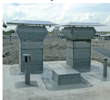
Kattolaitteet ja ilmastoinnit
